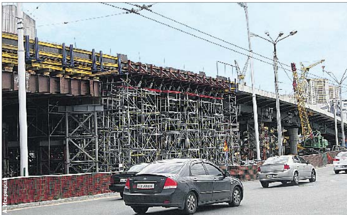
Московская площадь. Строители работают в три смены, говорят, что почти все готово
